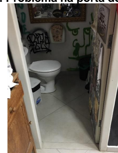
Figura 1. Problema na porta do banheiro.
